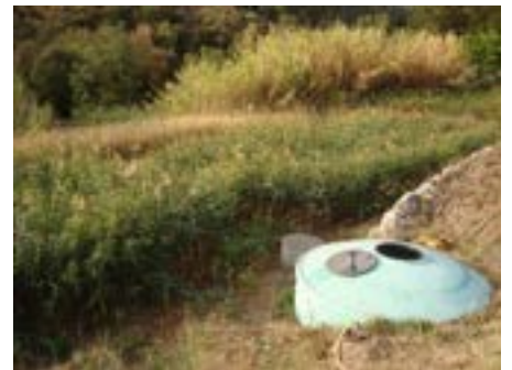
Deuxième cuve et roseaux
