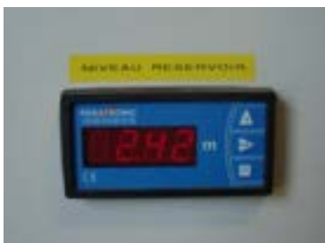
Contrôle du niveau d'eau dans la réserve
